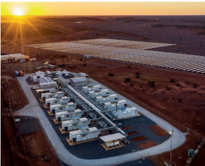
Energy Developments de CK Hutchison réalise un agrandissement de 4 MW de la mine d'or Agnew de Gold Fields en Australie-Occidentale. (Photo: CK Hutchison Holdings)
